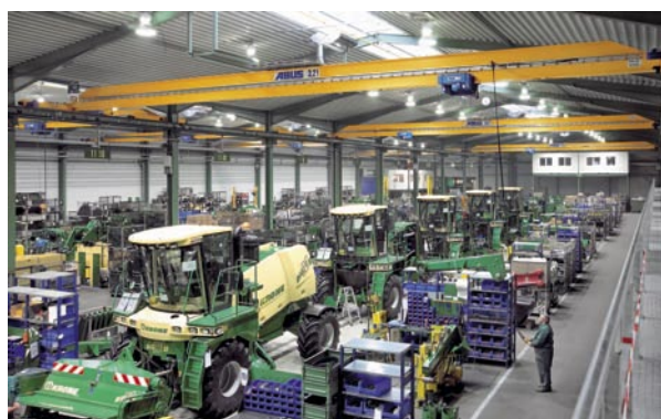
Poduri rulante monogriindă cu electropalane cu cablu, comandate în tandem ABUS ELK amplasate într-o fabrică de asamblare mașini agricole
