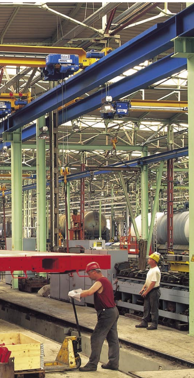
Patru electropalane ABUS E, cu comandă sincronă, utilizate într-o fabrică de structuri metalice
